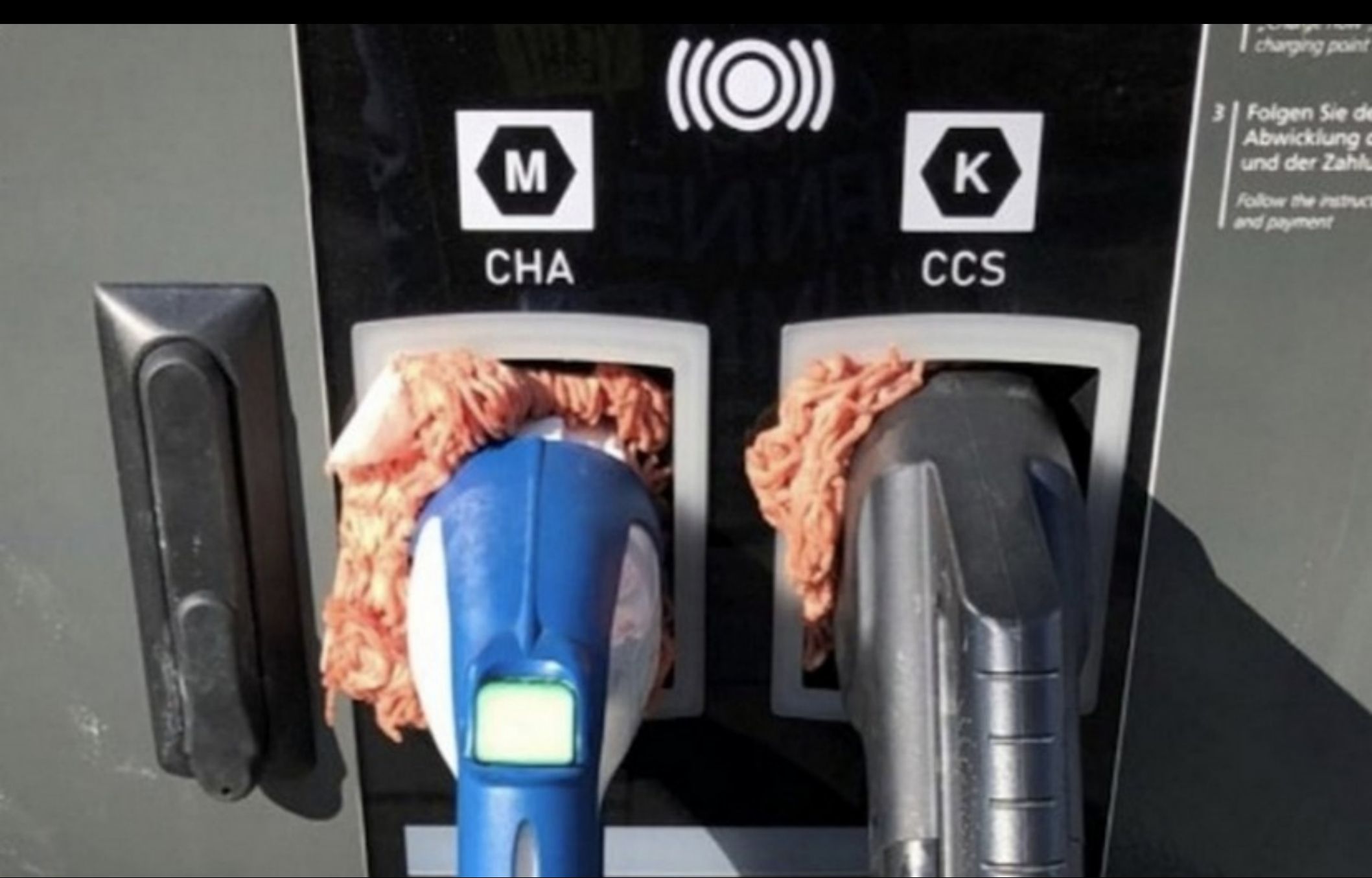
Carne picada en los cargadores de coches eléctricos
